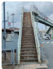
樹木が伐採された歩道橋
